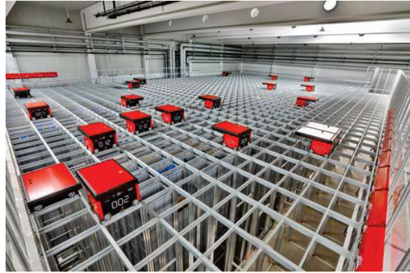
Teil des Neubaus war auch die Errichtung eines AutoStores (automatisches Kleinteillager).
